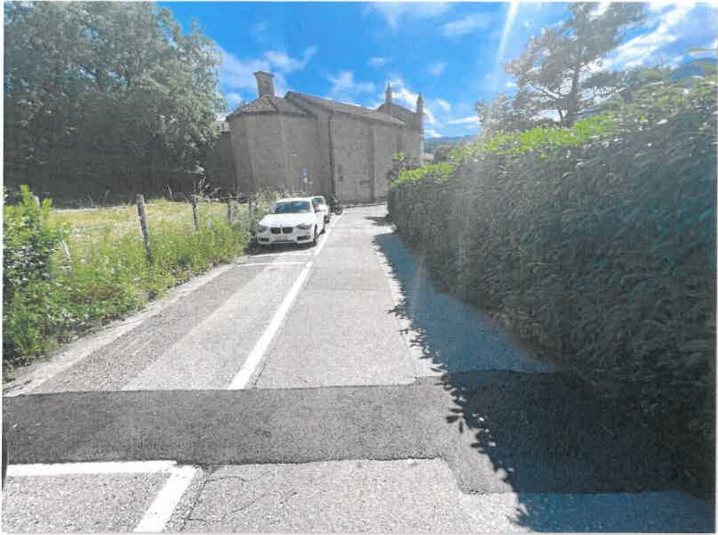
Foto no. 11 – Via Bossago, stato della pavimentazione
