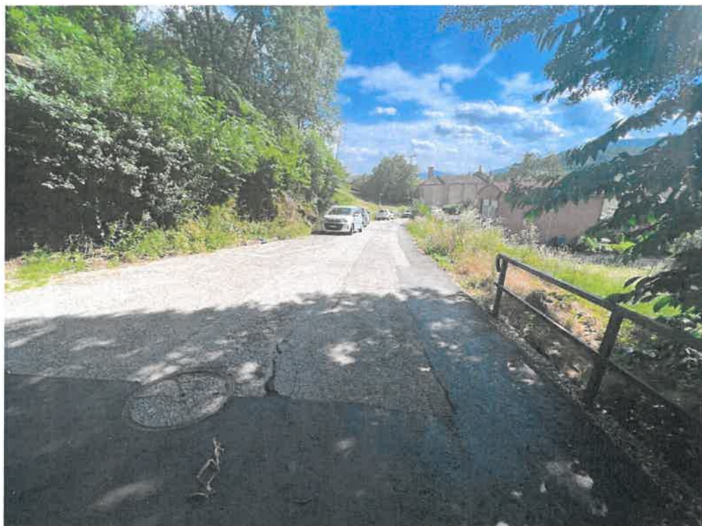
Foto no. 06 – Via Bossago, stato della pavimentazione
