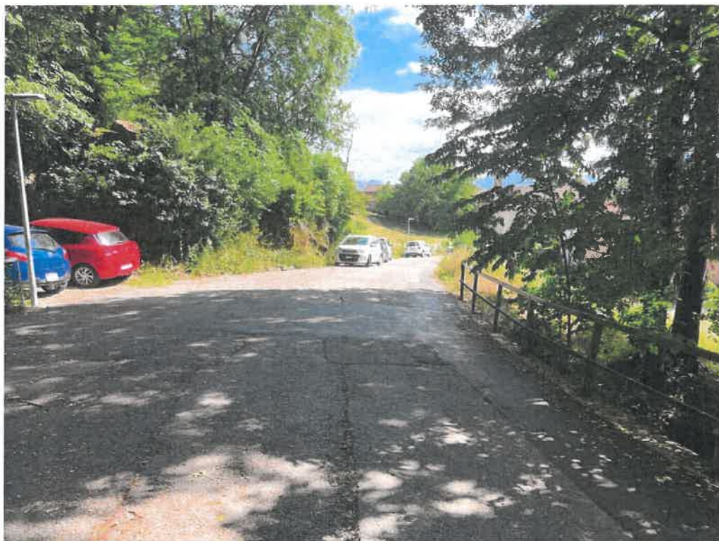
Foto no. 05 – Via Bossago, stato della pavimentazione
