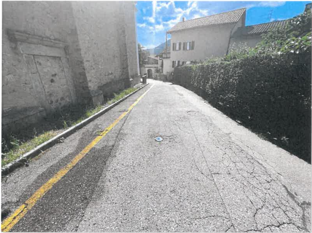
Foto no. 13 – Via Bossago, stato della pavimentazione
