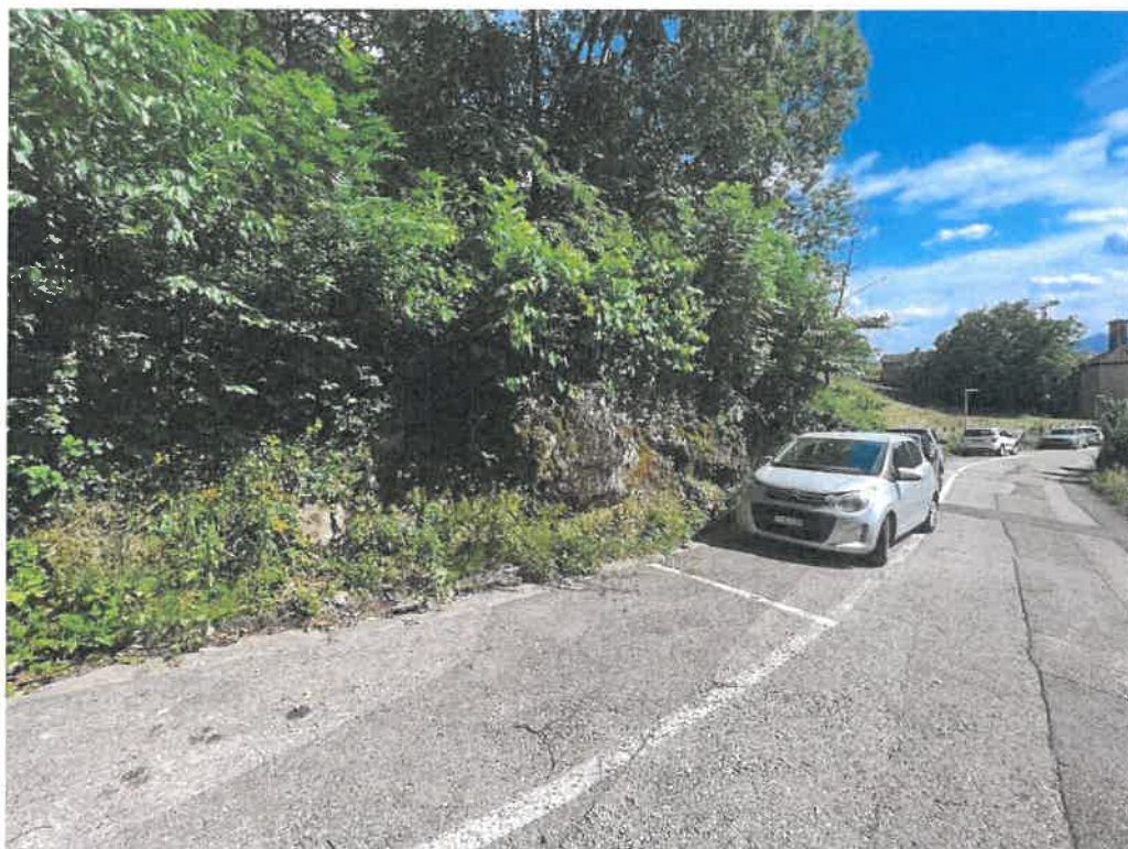
Foto no. 07 – Via Bossago, stato della pavimentazione
