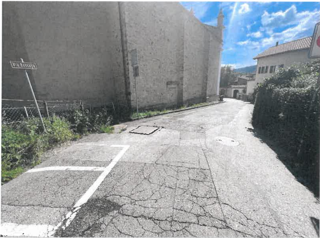
Foto no. 12 – Via Bossago, stato della pavimentazione
