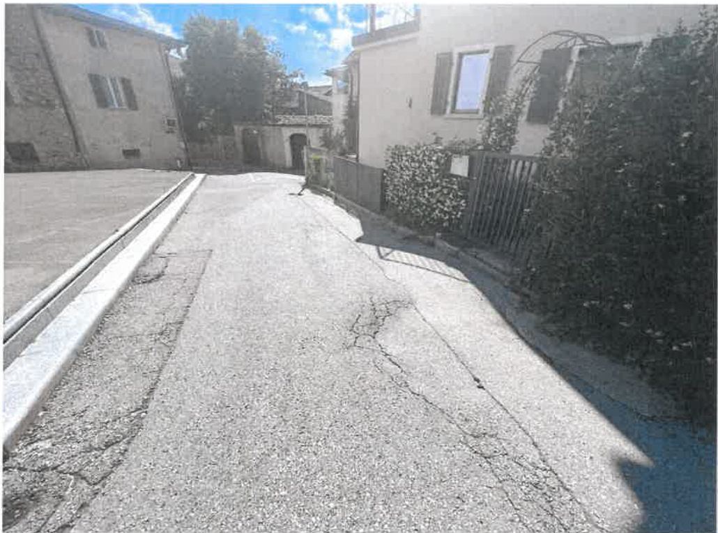
Foto no. 14 – Via Bossago, stato della pavimentazione
