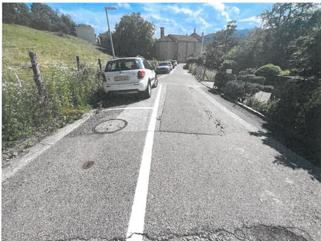
Foto no. 09 – Via Bossago, stato della pavimentazione
