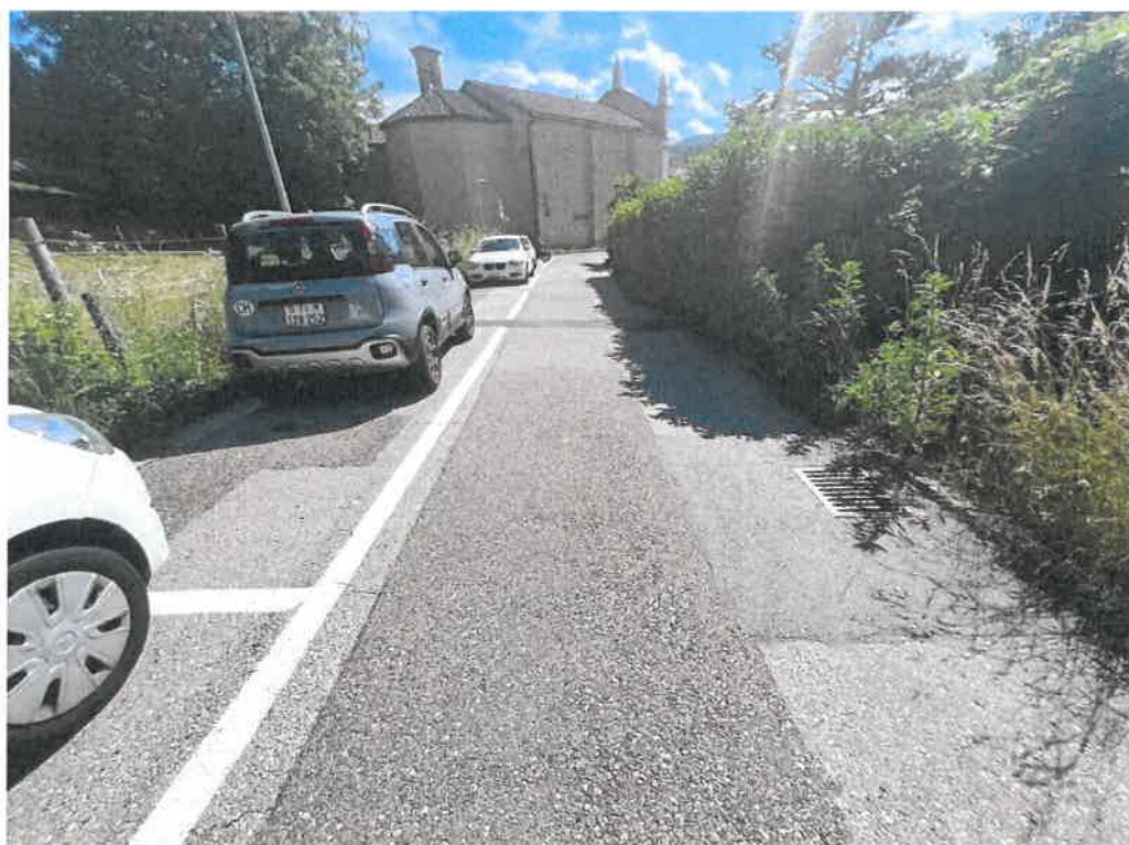
Foto no. 10 – Via Bossago, stato della pavimentazione
