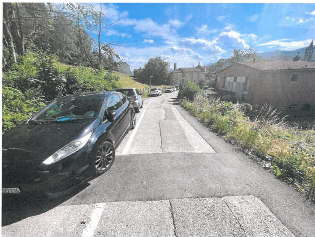
Foto no. 08 – Via Bossago, stato della pavimentazione
